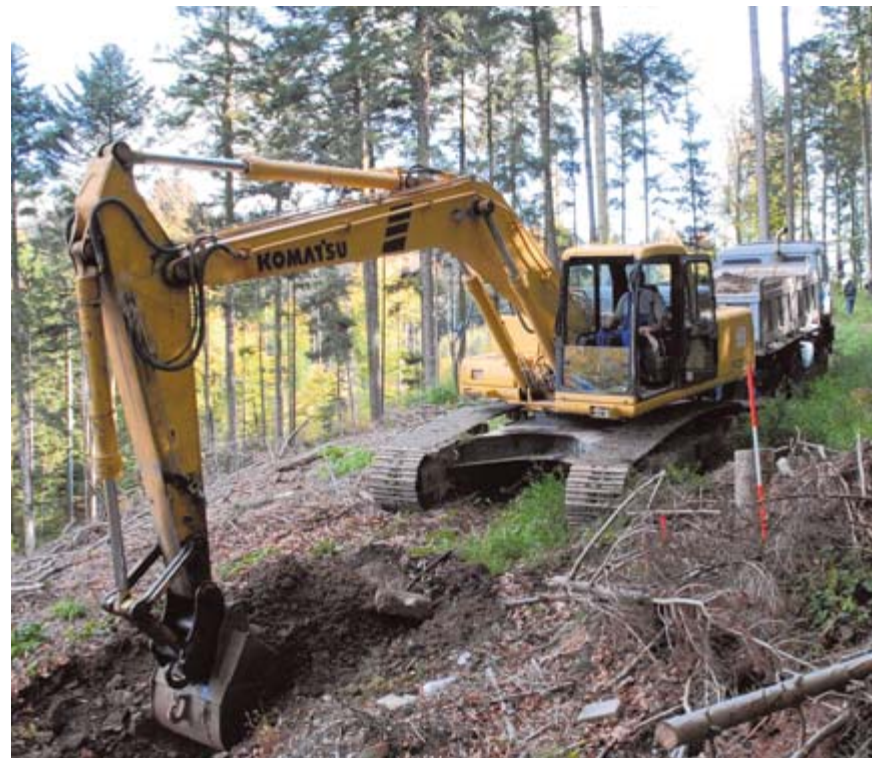
Aus den Grundstücken eines Privatwaldbesitzers wurde zwar das umstrittene Material entfernt, der Streit darüber ist aber noch nicht beendet. ARCHIVBILD: OBERMEYER
